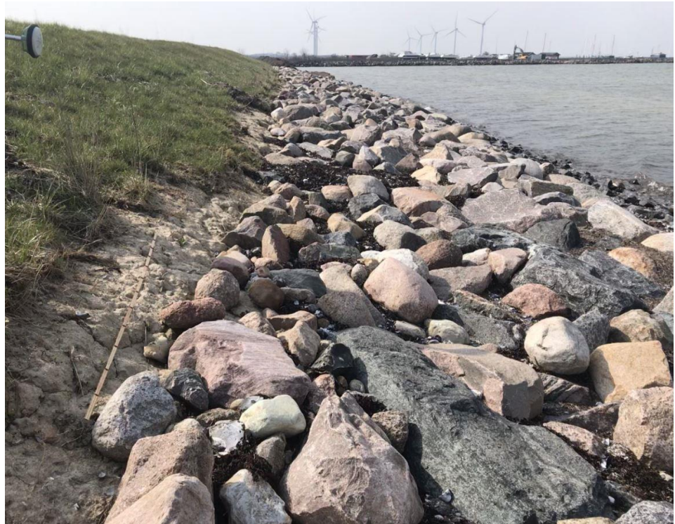
Figur 3.8: Erosionsskår i diget, hvor skråningsbeskyttelsen slutter. Græs og muld er bort-eroderet og leret ligger eksponeret for bølger. Skråningsbeskyttelsens stenstørrelser er meget (for) varierede og der er mange mindre sten øverst i skråningsbeskyttelsen som sandsynligvis bliver hvirvlet rundt af bølgerne og derved er primære værktøj til erosionen.
