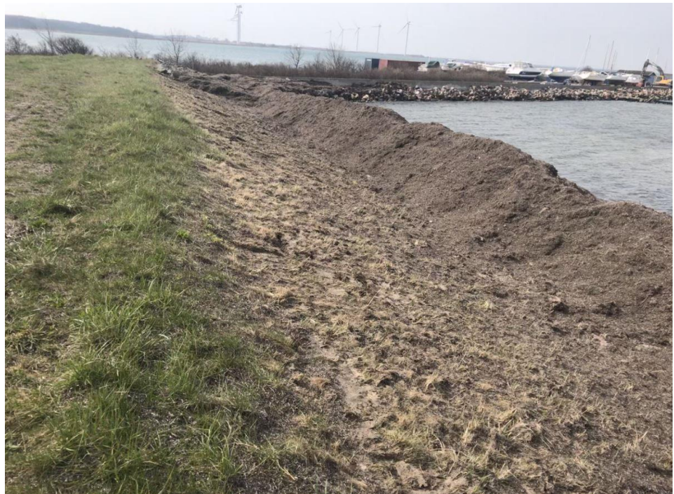
Figur 3.12: Tangbjerge på skråningsbeskyttelsen fra skrabet af diget siden de sidste storme. Mulden er desværre skrabet med flere steder og bør retableres med græs.
