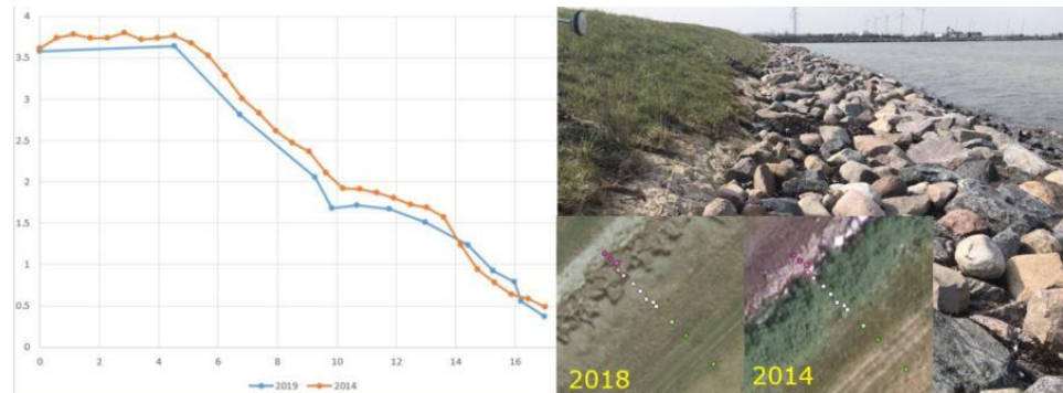
Figur 3.10: Tværsnit F viser tydeligt erosionsskåret i overgangen fra dige (hældning 1:3) til skråningsbeskyttelse i ca. 1,7 m DVR90 med overordnet hældning 1:6. 2014-målingen (orange) viser vegetationsoverfladen til midt på skråningsbeskyttelsen i 1,25 m højde. Derfra mod havet er terrænet ligesom tværsnit E højere i 2019 end i 2014, svarende til stenopfyld med sprængsten.
